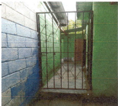
Foto 3: Sustrucción de puerta de metal de rejas
